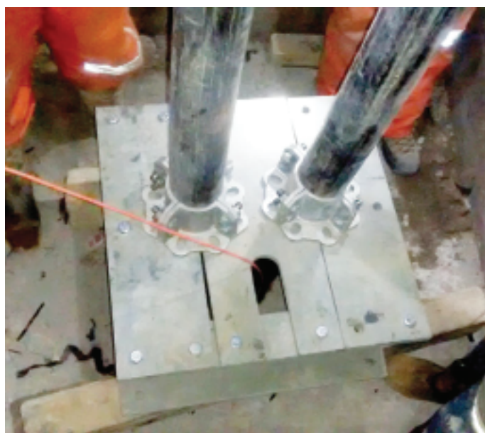
Трубы, поддерживаемые четырехсторонними зажимами
